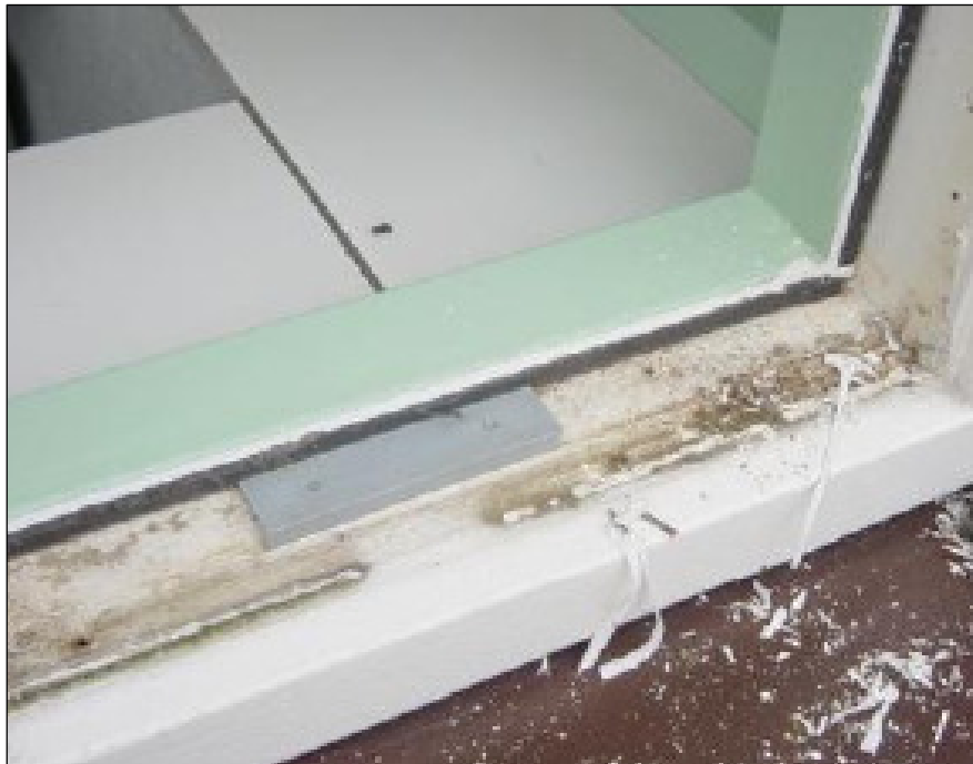
Vervuiling onder de liggende glaslat.
